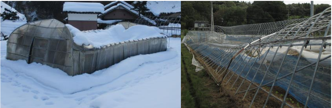
積雪・台風によるビニールハウスの被害
