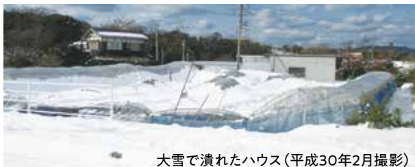
大雪で潰れたハウス(平成30年2月撮影)
