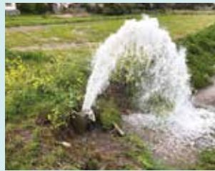
決壊したパイプ
