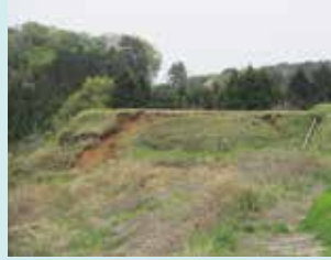
崩落した畦畔
