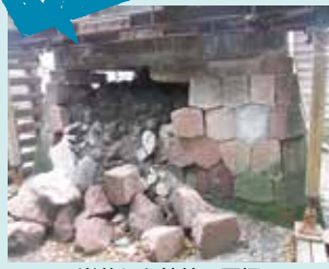
崩落した神社の石垣
