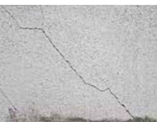
外壁のひび割れ
